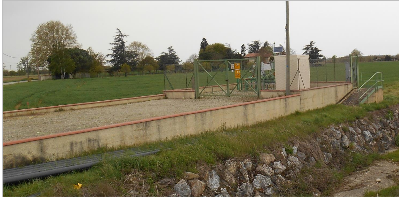
Photographie 19 : Station de contrôle de la canalisation de gaz située le long de la RD29
